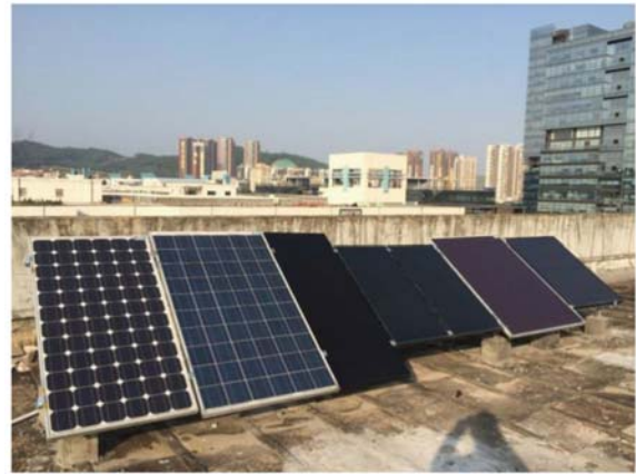
图2 龙岗铜铟镓硒中试基地屋顶太阳能电池实时连续测量系统
